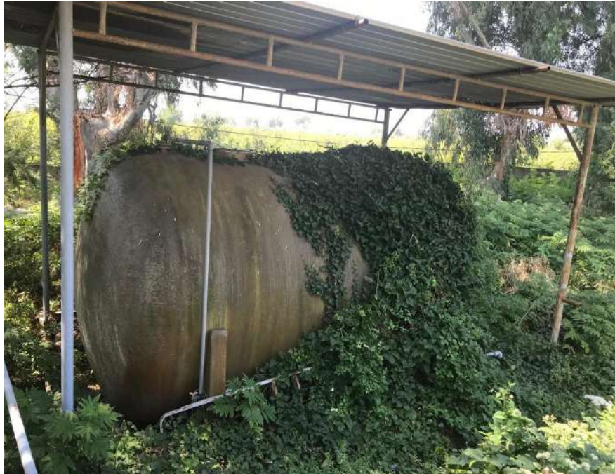
Figura 28: Serbatoio accumulo acqua antincendio
